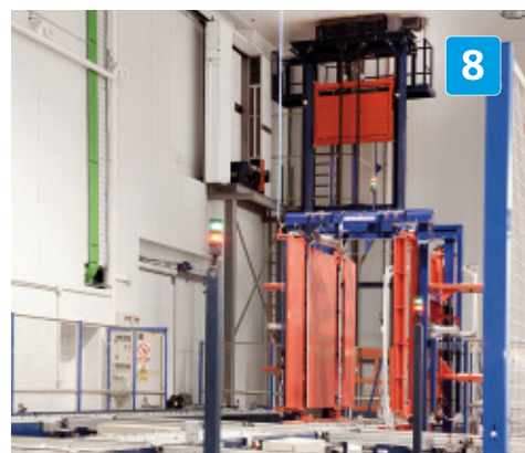
Los transportadores de rodillos o cadenas, el puesto de control automático, la compactadora, los elevadores y los elementos de seguridad y control garantizan un transporte automático, seguro y de alta capacidad.
