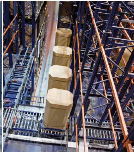
Transportadores de pasillo de almacenaje.
